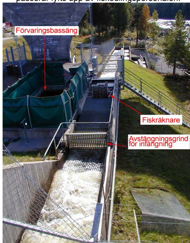
Bild 3. Sikfors fisktrappa med fiskräknare, förvaringsbassäng och fångstanordning.
